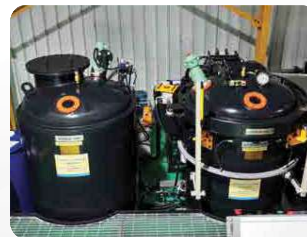
HỆ THỐNG NGÂM TẮM
