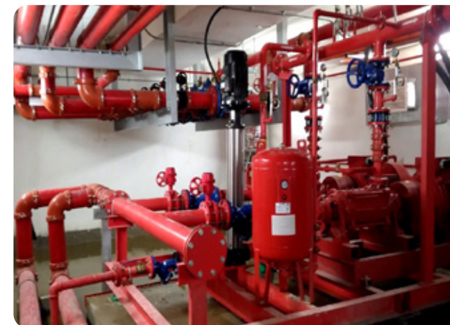
HỆ THỐNG PCCC FIRE PROTECTION SYSTEM
