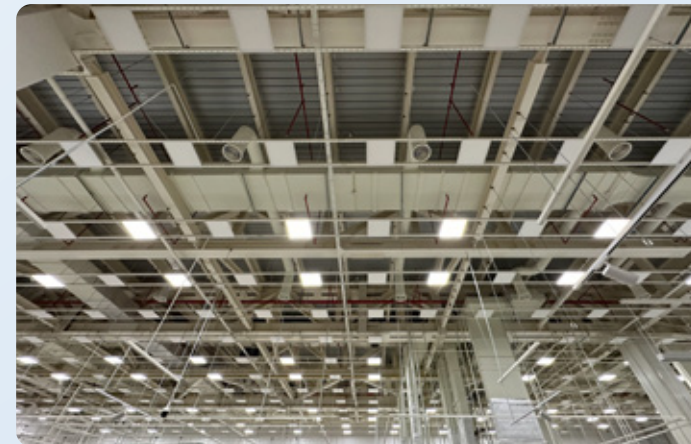
HỆ THỐNG ĐIỆN CHIẾU SÁNG ELECTRICAL LIGHTING SYSTEM
