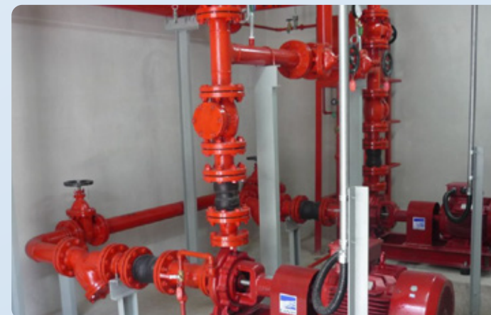
HỆ THỐNG PCCC FIRE PROTECTION SYSTEM
